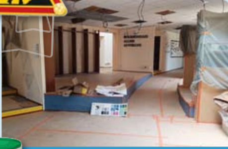
Chantier de la médiathèque après incendie
