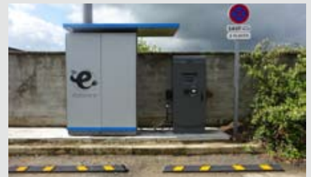
► Aire de recharge pour voitures électriques sur le parking de la salle Laurent GRILLET
