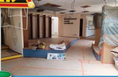
Chantier de la médiathèque après incendie
